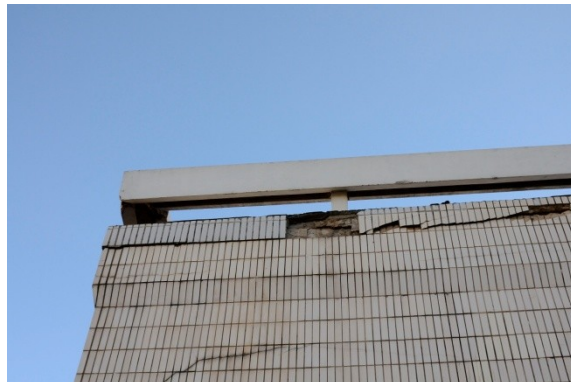
Desprendimento de revestimentos, sinais de infiltração e guarda-corpo desalinhado, na face norte do estacionamento em frente ao Conjunto Nacional.
