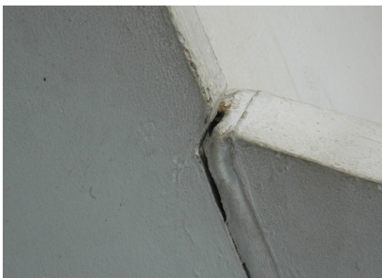
Detalhe das emendas das muretas laterais junto ao acesso ao mezanino do Museu.
