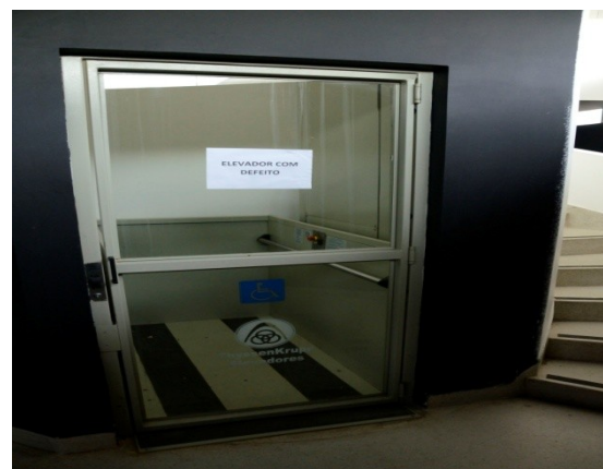
Elevador com defeito, sem contrato de manutenção.
