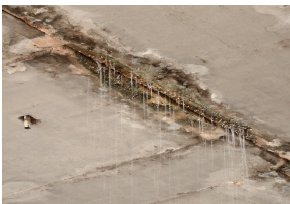
Infiltração nas juntas de dilatação do viaduto da plataforma superior da rodoviária.
