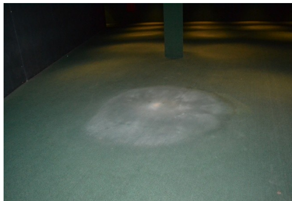
Mofo no carpete da Sala Villa-Lobos.
