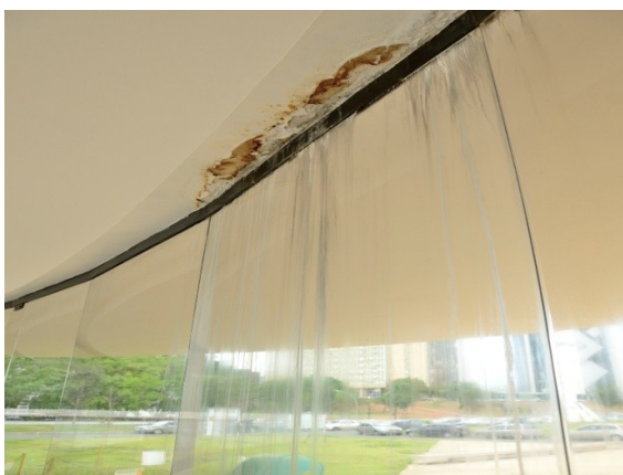
Infiltração nas esquadrias do anexo do Museu.
