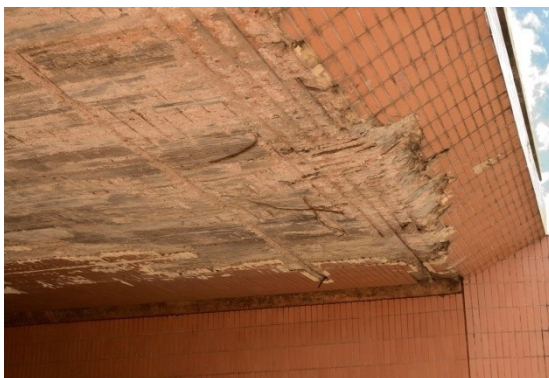
Tabuleiro do viaduto do eixo L entre as quadras 203/204 norte apresentando armadura metálica rompida.
