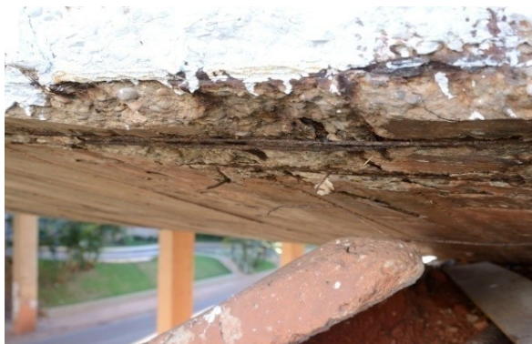
Armadura metálica aparente no viaduto do eixo W sobre a N2 apresentando sinais de corrosão.
