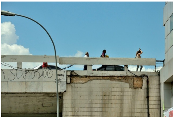
Desprendimento de revestimentos, sinais de infiltração e guarda-corpo desalinhado, ao lado do CONIC.
