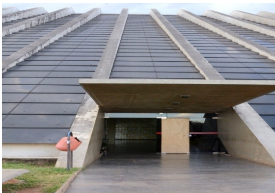
Porta da Sala Martins Penna quebrada.
