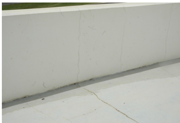
Rachadura na Rampa Lateral Sul do Museu.
