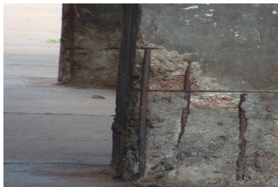
Armaduras metálicas dos pilares do viaduto do eixo L sobre a S2 expostas apresentando sinais de corrosão.
